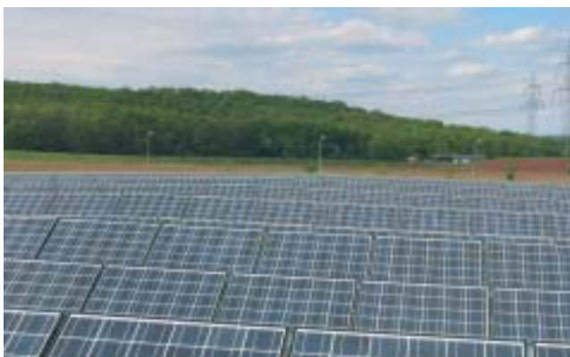
Solarstromanlage auf dem Dach von Wessamat
